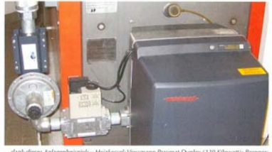
...dank dieses Anlagenbeispiels – Heizkessel: Viessmann Paromat Duplex (3,30 Kilowatt); Brenner: Weishaupt, WG 40 N1-A, Gasgebläsebrenner 370 Kilowatt; Ecopet Powerjet Professional 2600 (links oben). Erparung: 7,44 Prozent.
