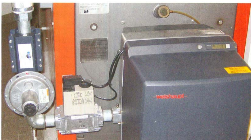
... dank dieses Anlagenbeispiels – Heizkessel: Viessmann Paromat Duplex (330 Kilowatt); Brenner: Weishaupt, WG 40 N/1-A, Gasgebläsebrenner 370 Kilowatt; Ecojet Powerjet Professional 2600 (links oben). Einsparung: 7,44 Prozent.
