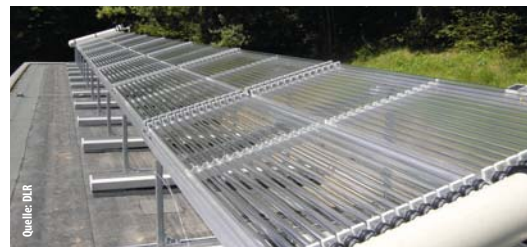
Quelle: DLR Nationales Siegerprojekt: Solare Wasserreinigungsanlage
