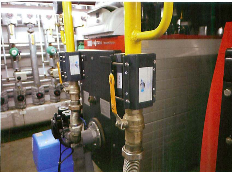
Klein und unauffällig werden die Ecojet-Magneten auf die Brennstoffzuleitung installiert und entfalten dort ihre Wirkung.
